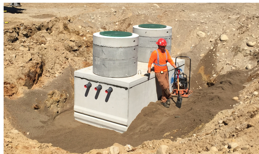
► Nouveau champ d'épuration du projet Lac Windfall
